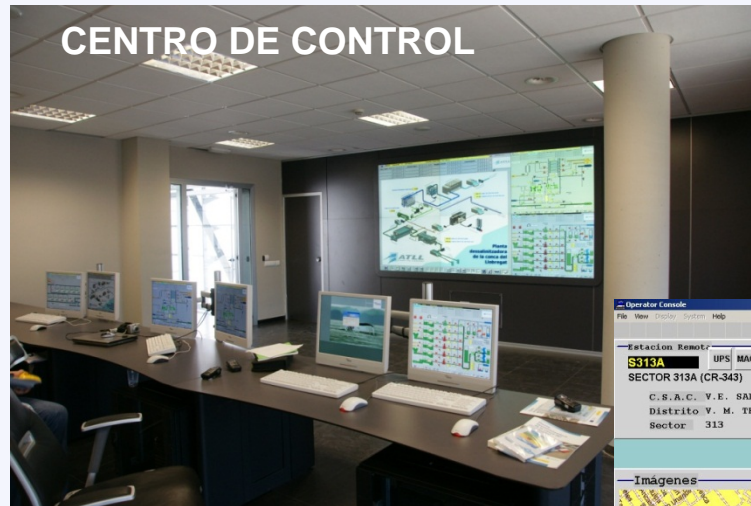
Centro de Control y SCADA SEDAPAL.
