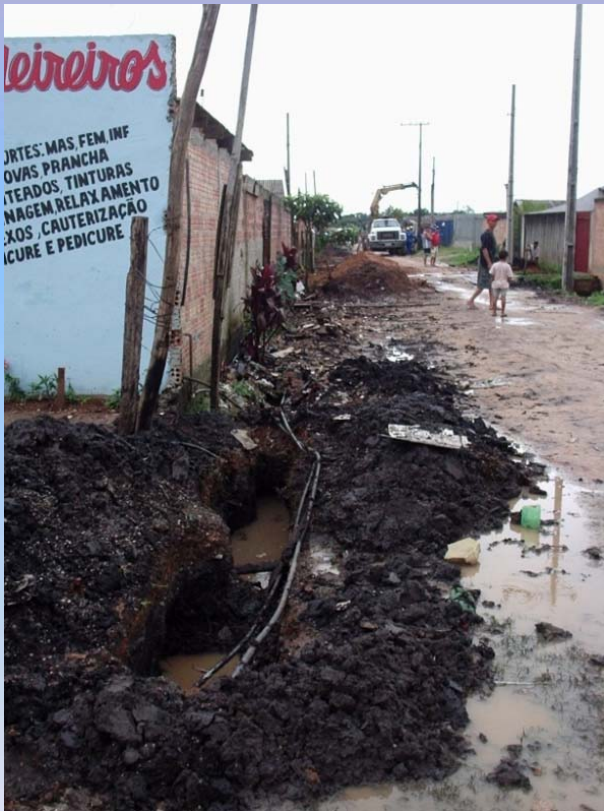
Ligações irregulares de água
