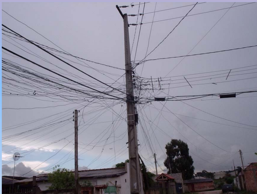
Ligações irregulares de energia elétrica
